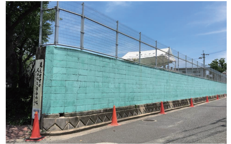
福岡市・城南小学校にあった、国の基準を満たさないブロック塀 (大阪北部地震後に撤去されました)
